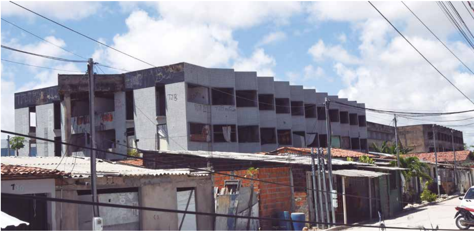
Hotel Cabo Branco (ao fundo) começou a ser construído na década de 1990, mas nunca foi concluído; apesar dos riscos, há 10 famílias que ocupam a edificação
